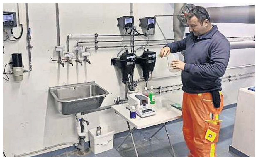
Prüfen von Trinkwasserparametern in der Trinkwasseraufbereitungsanlage Naila.
